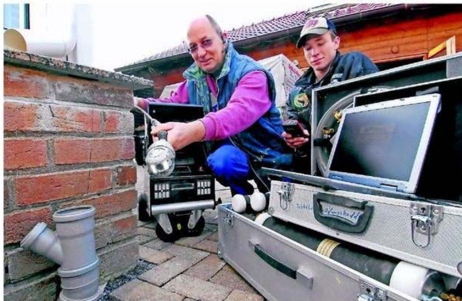
Mit einer kleinen Kamera , die in die Kanäle eingeführt wird, können die Techniker erkennen, ob diese auch dicht sind: Genau das ist eine Dichtheitsprüfung. RP-ARCHIVFOTO: MATZERATH
