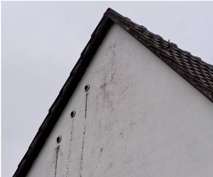
Abbildung 12: Löcher (Belüftung) an der Giebelseite des Wohngebäudes mit darunter befindlichen Kotspuren (eigene Aufnahme 27.03.2024)
