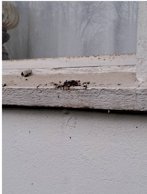
Abbildung 14: Vogelkot auf einer Fensterbank unter den Spalten der hölzernen Wandverkleidung (eigene Aufnahme 27.03.2024)
