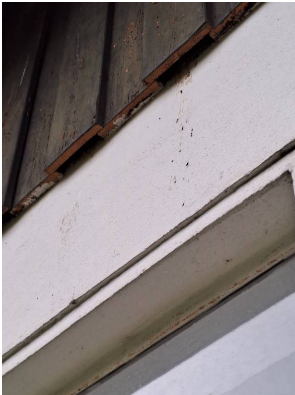
Abbildung 13: Hölzerne Wandverkleidung mit breiten Spalten und darunter befindlichen Spuren von Vogelkot (eigene Aufnahme 27.03.2024)
