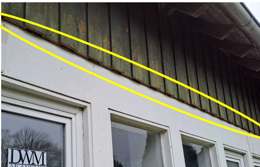
Abbildung 11: Hölzerne Wandverkleidung an der südlichen Gebäudeseite mit breiten Spalten als mögliche Zugänge für Fledermäuse (eigene Aufnahme, 27.03.2024)
